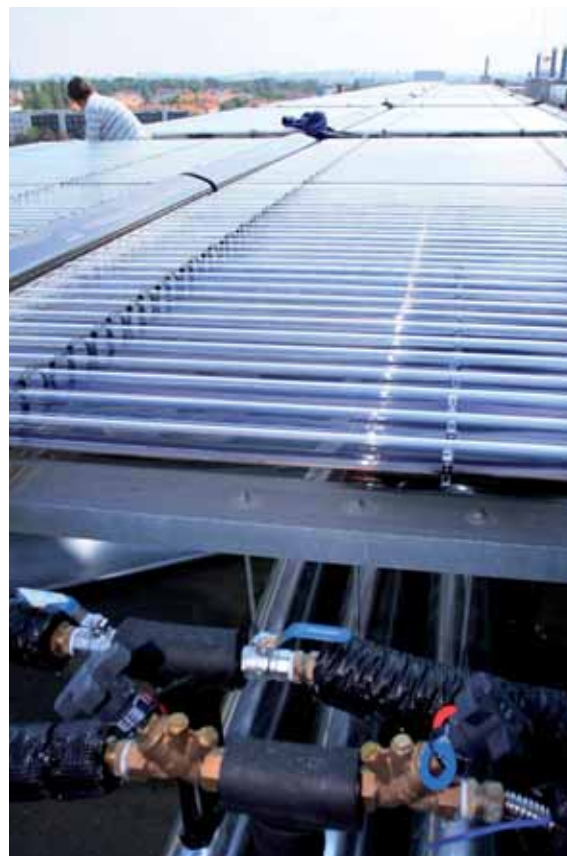
Panele słoneczne na D.S. „Zbyszko”
